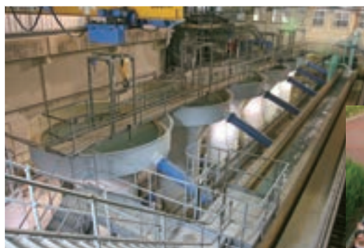
原水の地下水からカルシウム分を除去し、軟水化処理を実施(エルマー浄水場)
