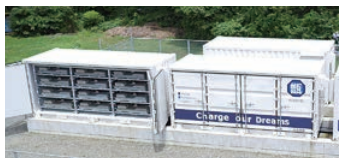
20フィートコンテナに配置されたリユース蓄電池
