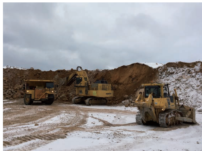
鉱山採掘現場は、広大なロシアの極寒地に点在。24時間体制で機械の保守・整備を行い、顧客の生産現場を支える
