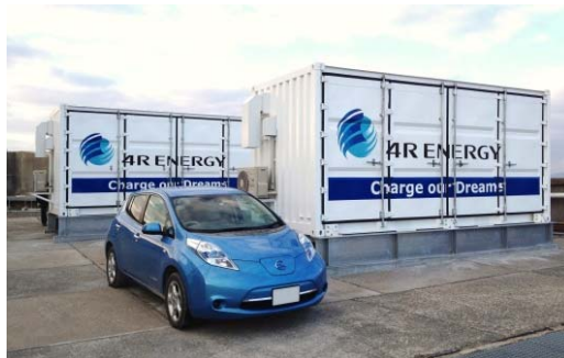
リユース蓄電池の活用
