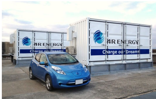
リユース蓄電池の活用
