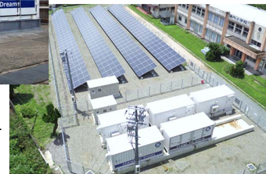
右：甕島蓄電センター（鹿児島県薩摩川内市）
