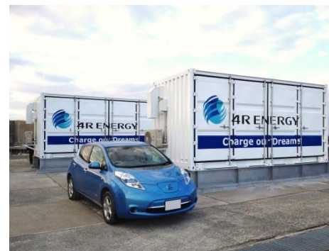
左：世界初の大型EVリユース蓄電池システム（大阪市夢洲）
