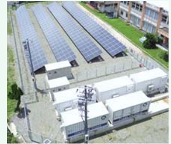
新潟蓄電センター(鹿児島県薩摩川内市)
