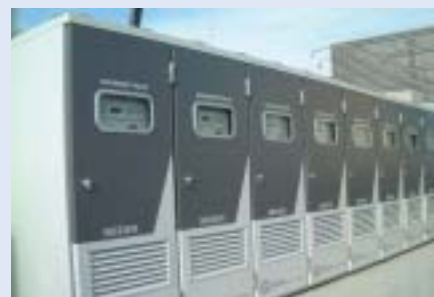
九州の病院に納入したマイクロガスタービン コージェネシステム
