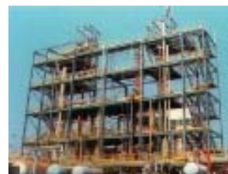
インドのフロン類 (HFC23) を破壊する設備
