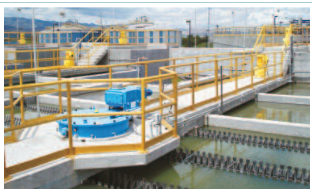
メキシコで運営しているサンルイスボトシ下水処理施設
