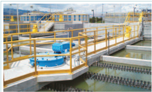
メキシコで運営しているサンルイスポシ下水道処理施設
