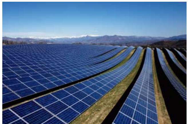
南フランス・レ・メ市の太陽光発電所
