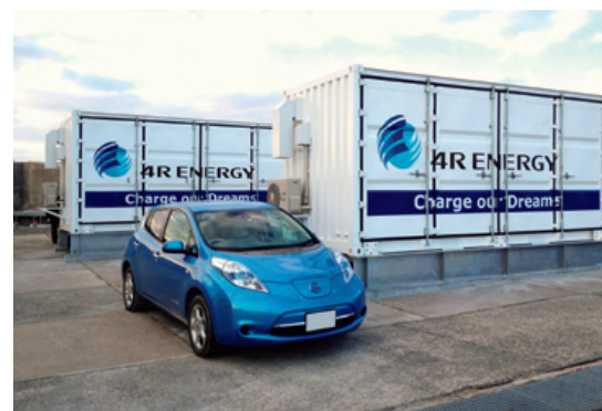
EV電池を再利用した大型蓄電池システム
