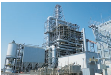
半田バイオマス発電所（愛知県）
