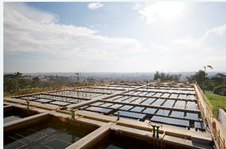
サンパウロ州 上水処理場
