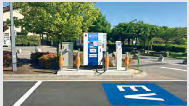
ジャパンチャージネットワークが設置した急速充電器の一例(美濃加茂SA)
