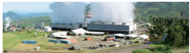
インドネシアのワヤン・ウィンドゥ地熱発電所
